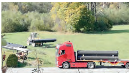
▲ RÉSEAU D'EAUX PLUVIALES HAUTERIVE
