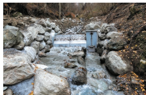
Prise d'eau en tyrolienne
